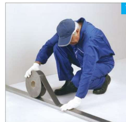
۴ اجرای نوار عایق (یا دو ردیف خمیر سیلیکون) بر پشت جان رانر کف و سقف
